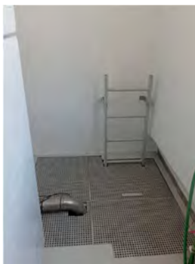
EEAR da Conceição – Instalação de Sistema DIP – Conclusão dos Trabalhos de Construção Civil
