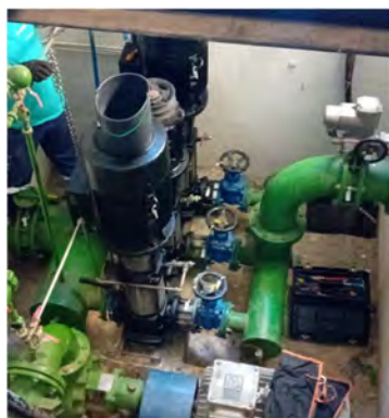
EEAA da Atrozela – Substituição dos Rolamentos do GE4
