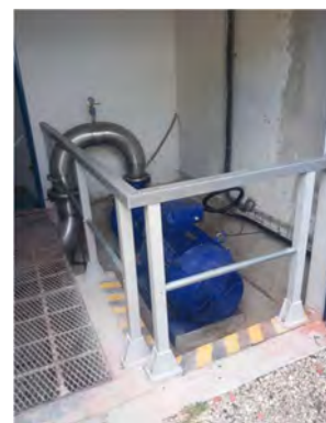
Reservatório do Goulão – Quadro Elétrico GE3
