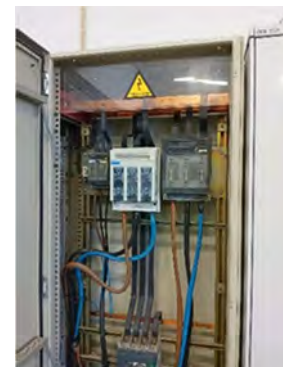
Reservatório de Moinhos de Rana - Substituição de acrílico no QE
