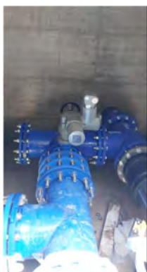
Reservatório de Alcoitão – Instalação da Válvula Monitorizada
