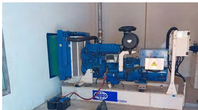
Reservatório de Moinhos de Rana – Ensaio do Gerador em Carga
