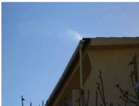
Infiltração detetada na rede predial
