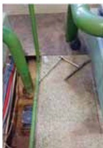
EEAA do Pisão – Verificação Desferra do GE2
