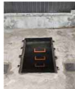
Estoril - Av. D. Nuno Álvares Pereira – Caixa da VRP
