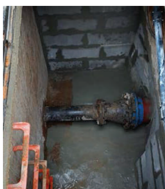
EEAR Malveira da Serra – Caixa do caudalímetro
