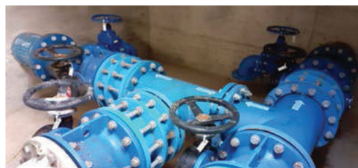
Reservatório de Alcoitão – colocação de etiquetas
