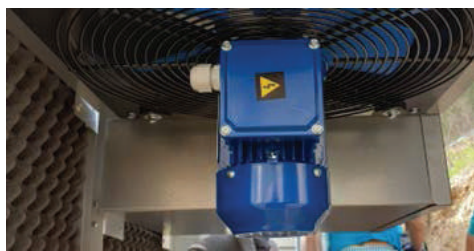
ETA do Rio da Mula – Instalação do Blower
