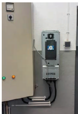
Booster de Porto Covo – substituição do conversor de frequência do G.E. 5
